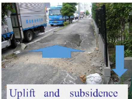
図-2 私有地の液状化によって道路が大変状した例
