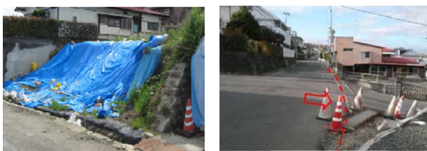
写真-1 ひな壇部の擁壁被害 写真-2 道路部の水平変位被害
