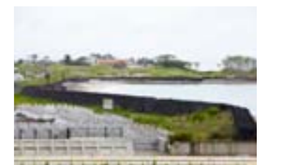
「道の駅 大谷海岸」前の美しい砂浜は地震による沈降、津波による侵食・流出により姿を無くした。
