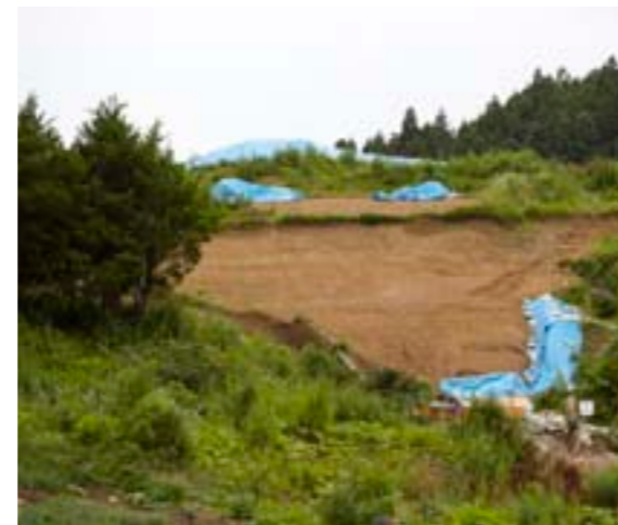
高台移転予定地区では、現在急ピッチで造成工事が進められている。
